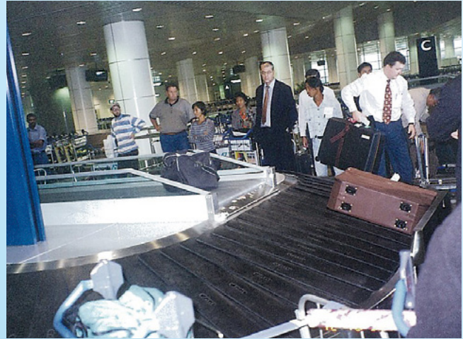
クアラルンプール国際空港のBHS
