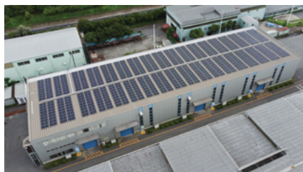
千葉事業所の太陽光発電設備
