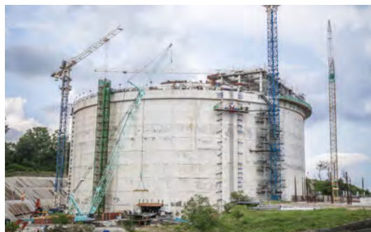
LNGタンクプロジェクト
